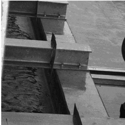
Abb. 6: Kühlwasser vor Einbau der UV-Desinfektion Fig. 6: Cooling water before installing the UV disinfection
