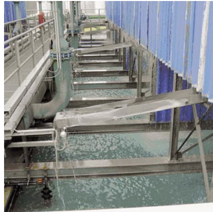
Abb. 7: Kühlwasser nach Einbau der UV-Desinfektion Fig. 7: Cooling water after installing the UV disinfection
