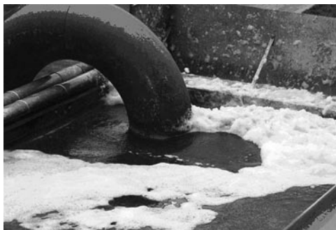
Abb. 3: Kühlwasser vor Einbau der UV-Desinfektion / Cooling water before installing the UV disinfection
