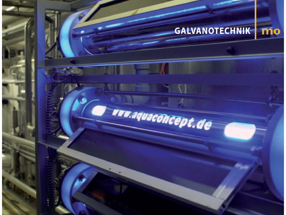
Das neue Enviolet-UV-Verfahren, das die Oxidation und das Verdampfen miteinander verbindet, verhindert Verdunstungsverluste sowie Nickelverschleppungen aus der Anlage und reduziert spürbar den Gesamtverbrauch an voll entsalztem Wasser Bilder: a.c.k. aqua concept
