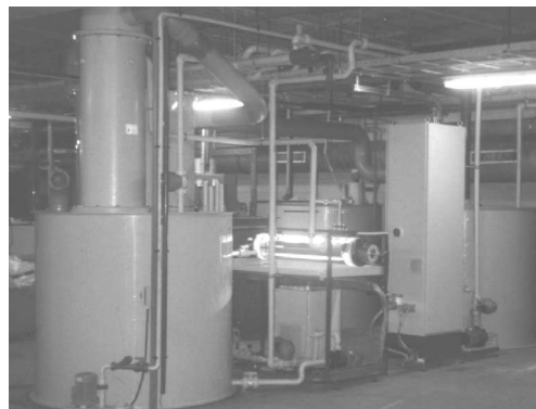
Abb. 2: Gesamtansicht der Behandlungsanlage bei Ramaer: Vorlagebehälter mit Direktkühler und Tropfenabscheider, UV-Oxidationsreaktor und Wärmequelle, Steuerschrank, Vorlagetank für Konzentrat (v.l.n.r.)
