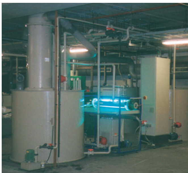
Bild 2. Gesamtansicht der Behandlungsanlage bei Ramaer. Von links nach rechts: Vorlagebehälter mit Direktkühler und Tropfenabscheider, UV-Oxidationsreaktor und Wärmequelle, Steuerschrank, Vorlagetank für Konzentrat
