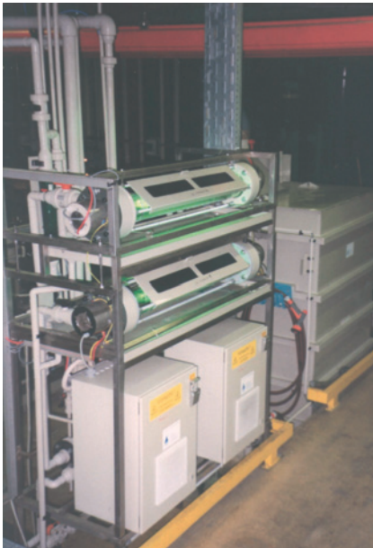
Bild 1. Anlage zur galvanotechnischen Badpflege mittels UV-Oxidation
