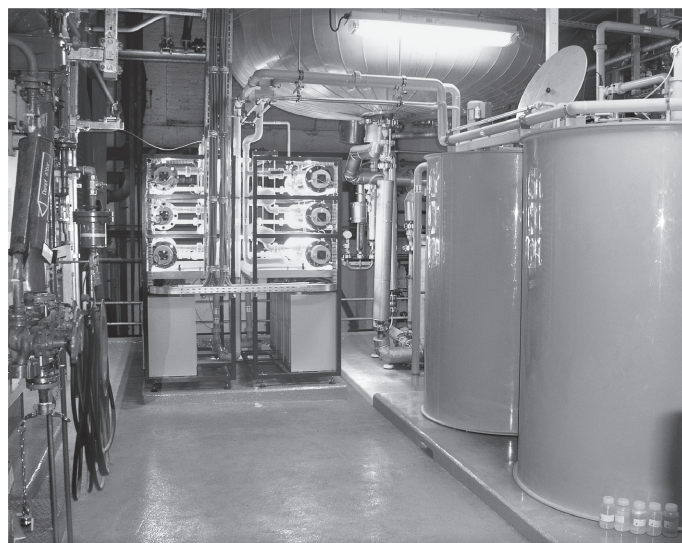
Abb. 1: Durchlaufanlage zur Entgiftung von ca. 10 m 3 /h komplexhaltigen Abwasser (EDTA, Amine, Carboxylate)
