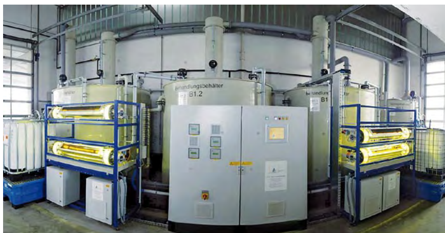
Bild 1: Die UV-Oxidation wird zur Behandlung von galvanischen Abwässern eingesetzt
