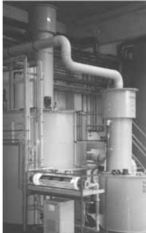
Abb. 5: Enviolet® -Anlage zur Behandlung von Abwässern aus dem Bereich „Chemisch Nickel“, wie in Tabelle 1 beschrieben. Die Behandlung erfolgt in 12 m 3 -Chargen nach einer festgelegten Behandlungssequenz in der alle Komplexbildner eliminiert werden. Nicht in der Abbildung enthalten sind die Dosierstation, der Schalt- und der Steuerschrank. Die Anlage kann ohne weiteren Platzbedarf auf die dreifache Tagesleistung ausgebaut werden (Werksfoto: a.c.k.)
