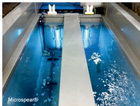
Abb. 4: Desinfektion von galvanotechnischen Spülen
