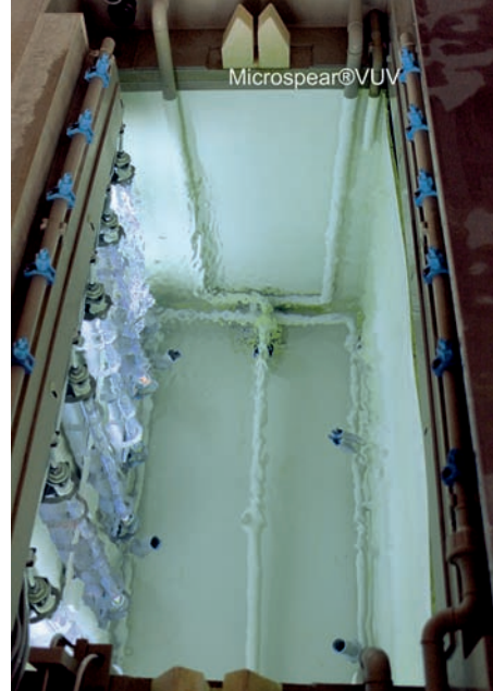
Abb. 7: TOC-Polisher zum Abbau von organischen Störstoffen in der letzten Spüle vor der Warenentnahme Fig. 7: TOC-Polisher for the degradation of organic interference matters in the last rinse tank upstream of the goods discharge
