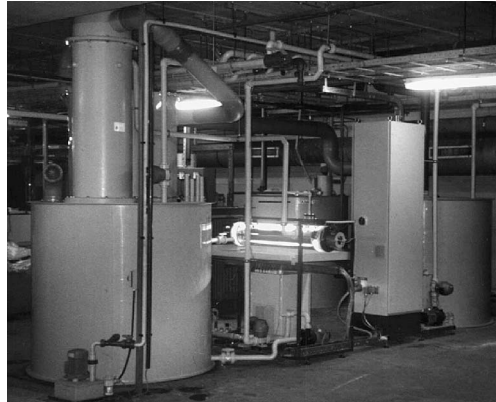
Abb. 2: Gesamtansicht der Behandlungsanlage bei Ramaer: Vorlagebehälter mit Direktkühler und Tropfenabscheider, UV-Oxidationsreaktor und Wärmequelle, Steuerschrank, Vorlagetank für Konzentrat (v.l.n.r.)
