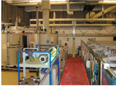
Abb. 4: Die Enviolet ® -UV-Oxidationseinheit und vollautomatische Anlagensteuerung mit ZLT-Anbindung ist vollständig in die Galvanik integriert
