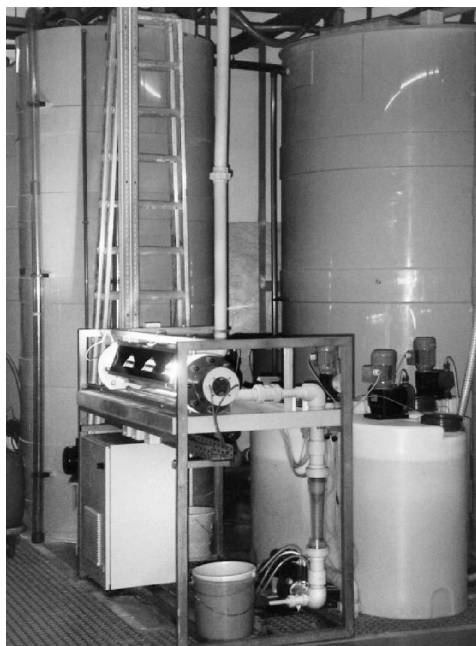
Abb. 3: 12 kW- Enviolet ® -UV-Anlage und Verfahrenstechnik (im Hintergrund)
