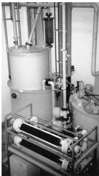
Abb. 5: Cyanomat® bei tap: links vorne 24-kW-Enviolet®-UV-Anlage, links hinten Behandlungsbehälter der Hauptoxidation mit Gasreinigung, rechts hinten Behandlungstank der Voroxidation mit integrierter Verfahrenstechnik
